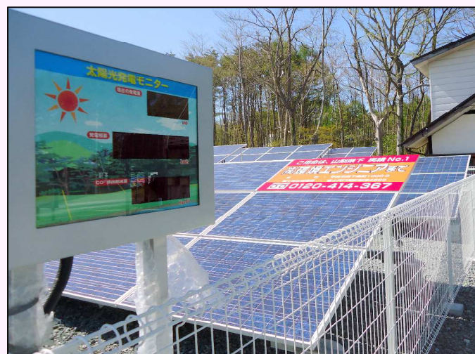
環境エンジニア山中湖発電所 48.6kw
